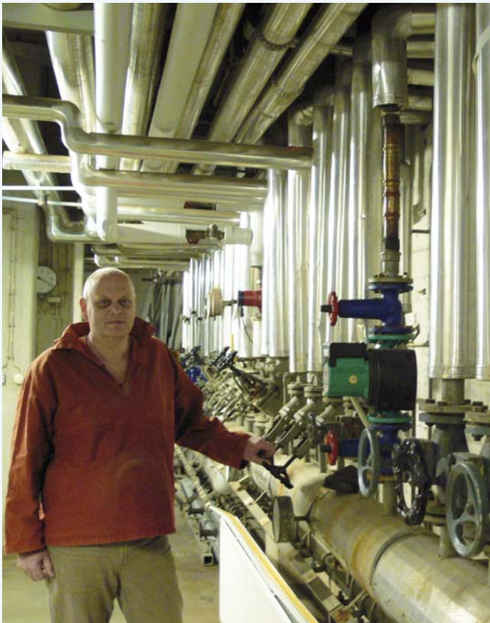
„Herr der Rohre“: Andreas Ziehn vor der gigantischen Heizungsanlage
