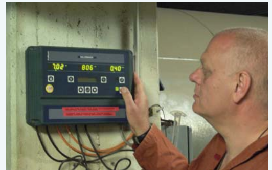
Morgentliche Kontrolle der Wasserqualität
